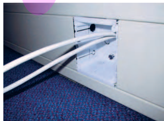
Gelegde UTP-kabels met overlengte
