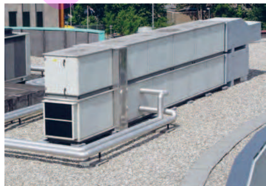
Luchtbehandelingsinstallatie op dak
