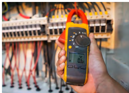
Stroommeting met een ampèretang
