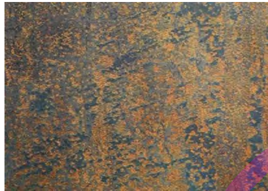
Walshuid op staalplaat
