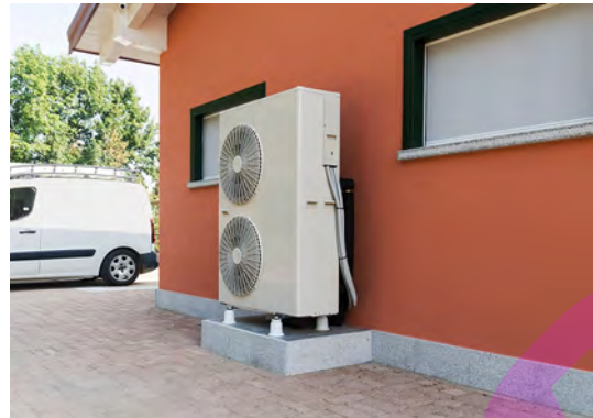
Warmtepomp bij een woning
